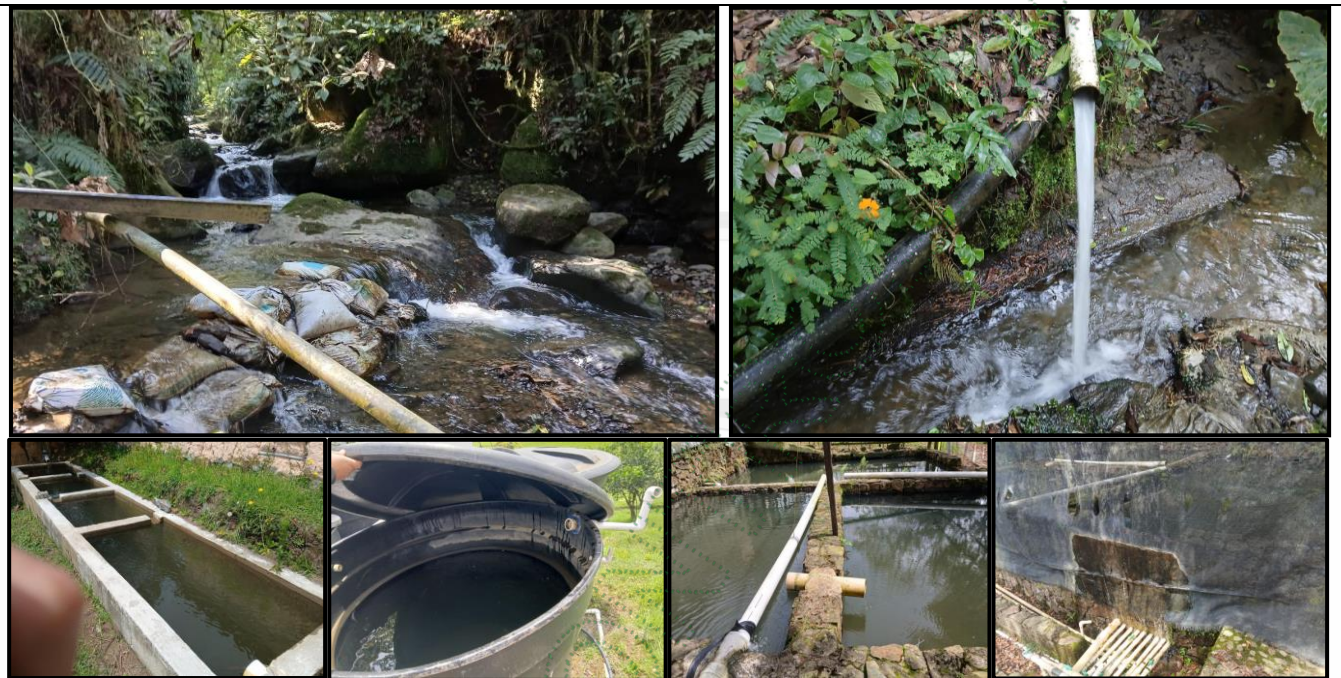
Imágenes 9, 10, 11, 12, 13 y 14: Fuente “La Uchuvala – Las Palmas”, acequia, desarenador y tanques de almacenamiento
