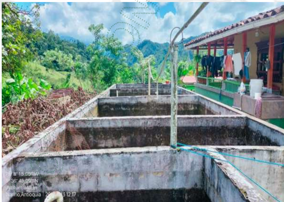
Imagen 8. Infraestructura que se tenía implementada para el proyecto piscícola, la cual se encuentra abandonada.
