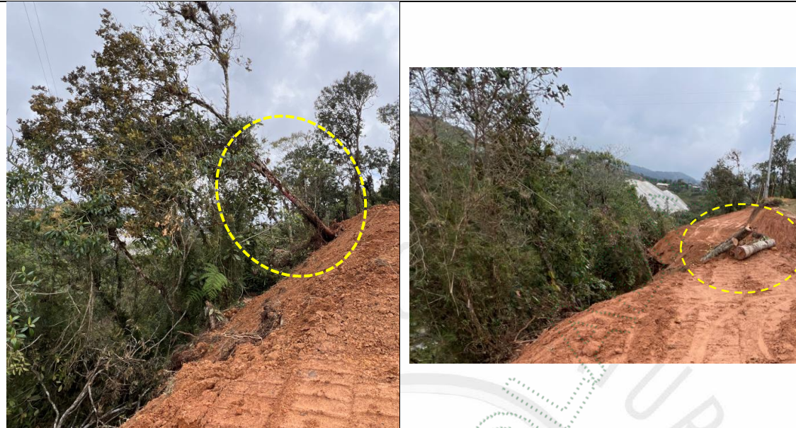
Foto 3 y 4. Evidencia de afectación de especies arbóreas por actividad de movimiento de tierras. Fuente: Cornare 2025.
