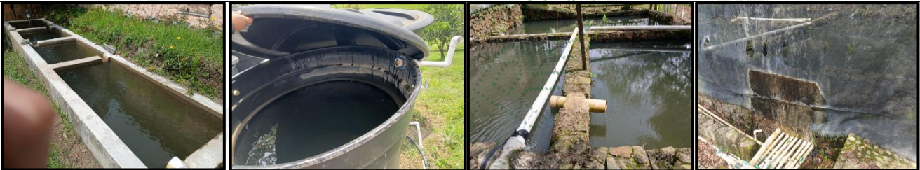
Imágenes 9, 10, 11, 12, 13 y 14: Fuente “La Uchuvala – Las Palmas”, acequia, desarenador y tanques de almacenamiento
