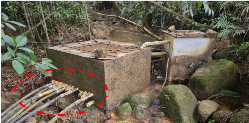
Figura 5. Desarenador y tanque de almacenamiento
