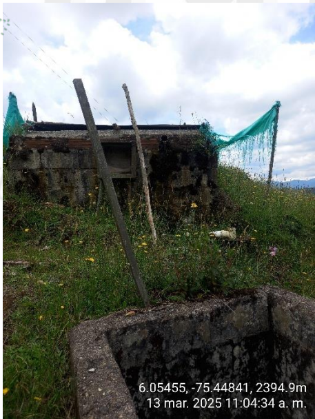
Imagen 5. Tanque de almacenamiento
