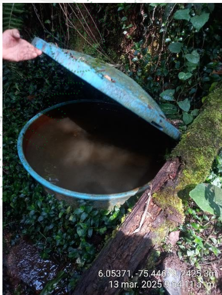
Imagen 2. Taque de captación
