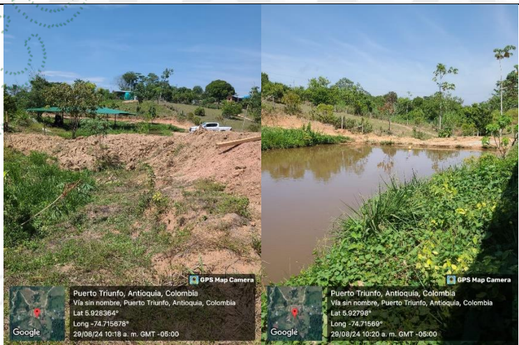
Figura 4. Condiciones encontradas durante la visita de campo día 29 de agosto de 2024, asociada a la intervención de cauce para lago ornamental
