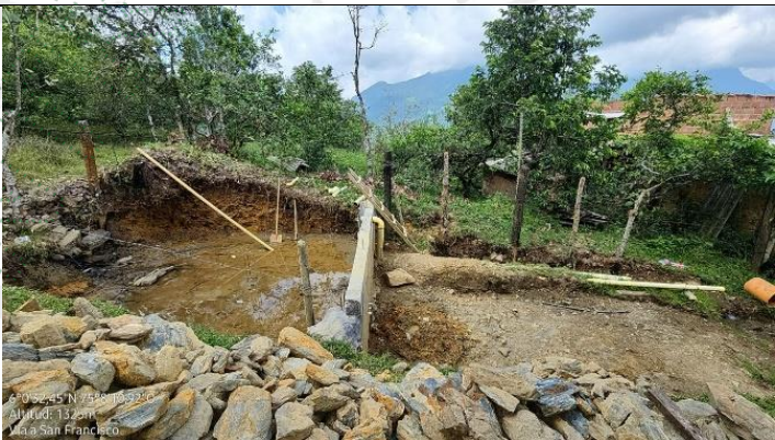
Imagen2. Construcción sobre el Cauce. Fuente: CORNARE 2024
