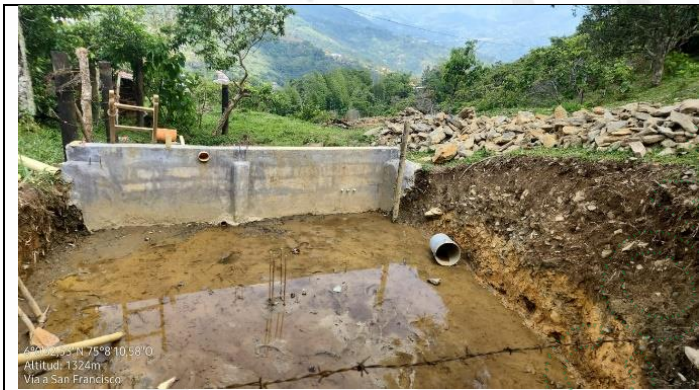
Imagen1. Construcción sobre el Cauce. Fuente: CORNARE 2024
