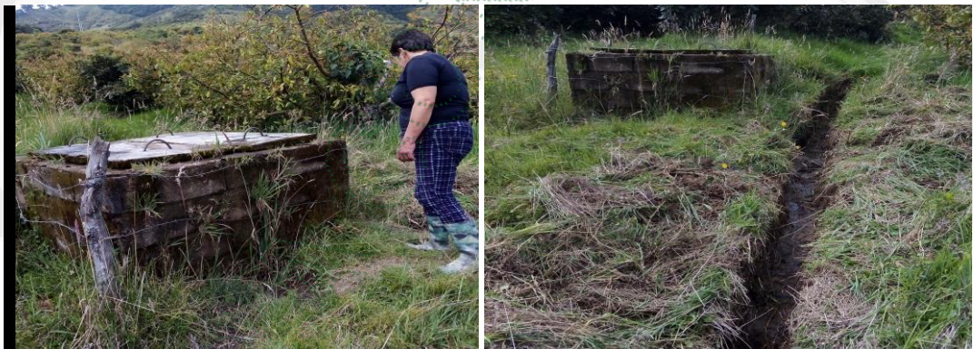
Ya no se evidencian fugas de agua
