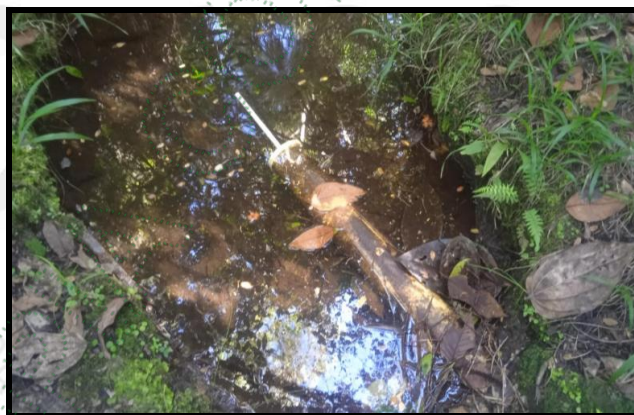
Imagen 1: Para la fuente “La Laja Tramo Alto”, tubería de 6” reducida a tubería de ½” en CPVC
