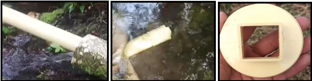
Imágenes 2, 3 y 4: Tubería de 6” por la cual es devuelto el caudal de rebose a la fuente, tubería de 3” con tapón al final y tapón perforado (obra de control).
