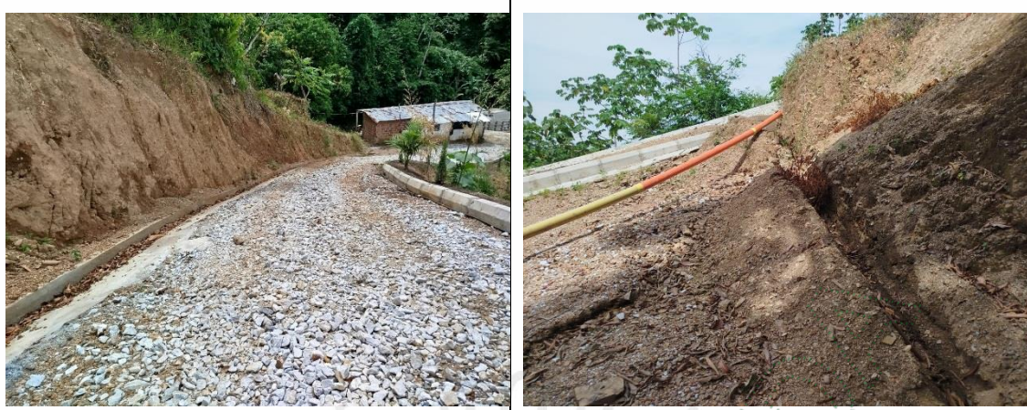
Figuras 1 y 2. Cunetas y canales implementados en el lugar de interés.
