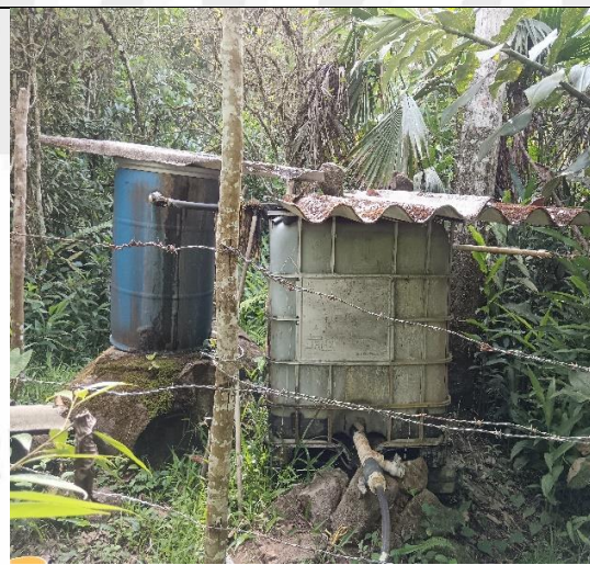
Imagen 5: Desarenador y tanque de almacenamiento
