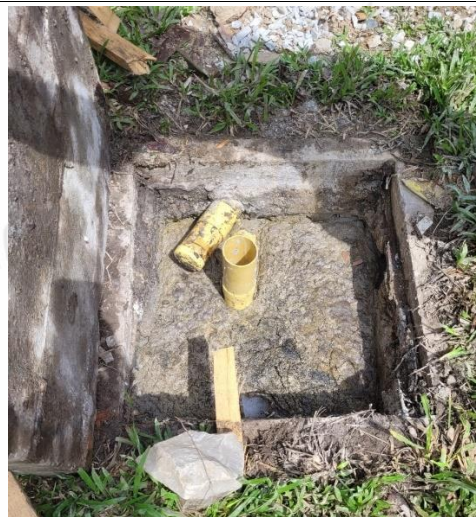
Figura 2. Estado actual Pretratamiento Segunda Trampa de grasas que recibe las aguas residuales del restaurante de la EDS
