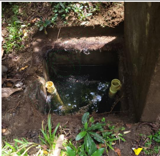
Figura 1. Estado actual Pretratamiento Primera Trampa de grasas que recibe las aguas residuales de los Baños de la EDS
