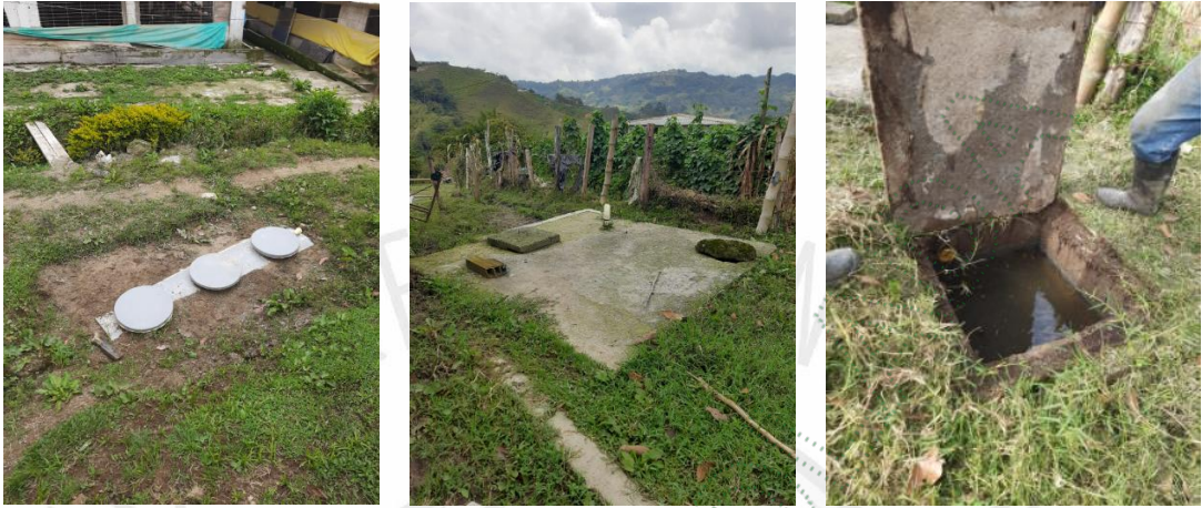
STARD 1 (casa principal), FAFA de pulimiento y caja de registro.
