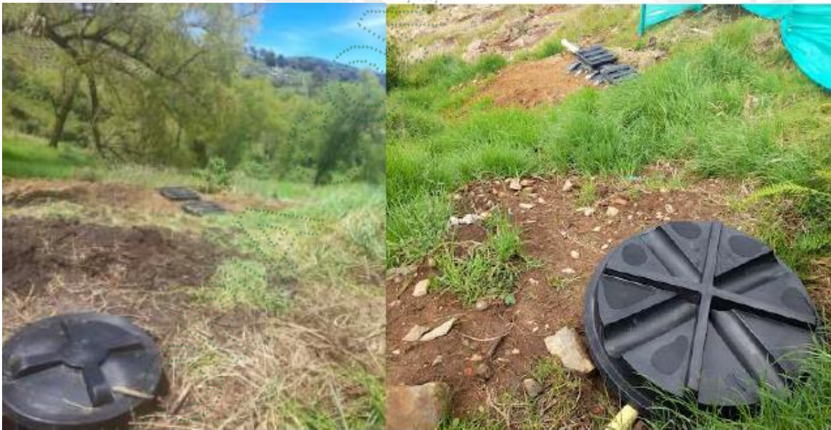
Fotografía 2. STARD instalado en las unidades habitacionales
