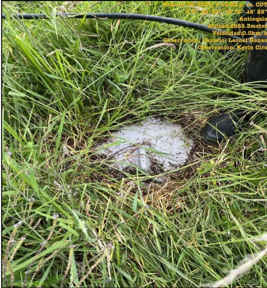
Imagen Nro.6: Sistema de Tratamiento de las Aguas Residuales vivienda Nro.1.
