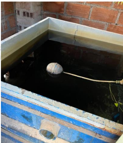
Imagen 5. Tanque de almacenamiento con dispositivo de control de flujo, CONGREGACIÓN DE LAS ESCLAVAS DE CRISTO REY
