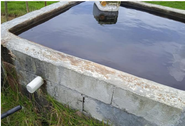
Imagen 2. Tanque de almacenamiento
