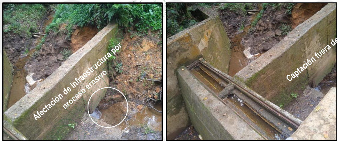
Imágenes 1 y 2: Obra de captación fuera de funcionamiento, con daños estructurales.
