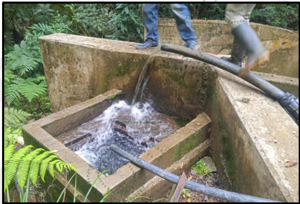
Imagen 3: Mangueras de 1 ½" y 3" descargando el recurso a la caja de derivación.
