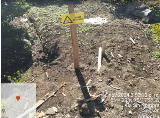
Pozo de desactivación
