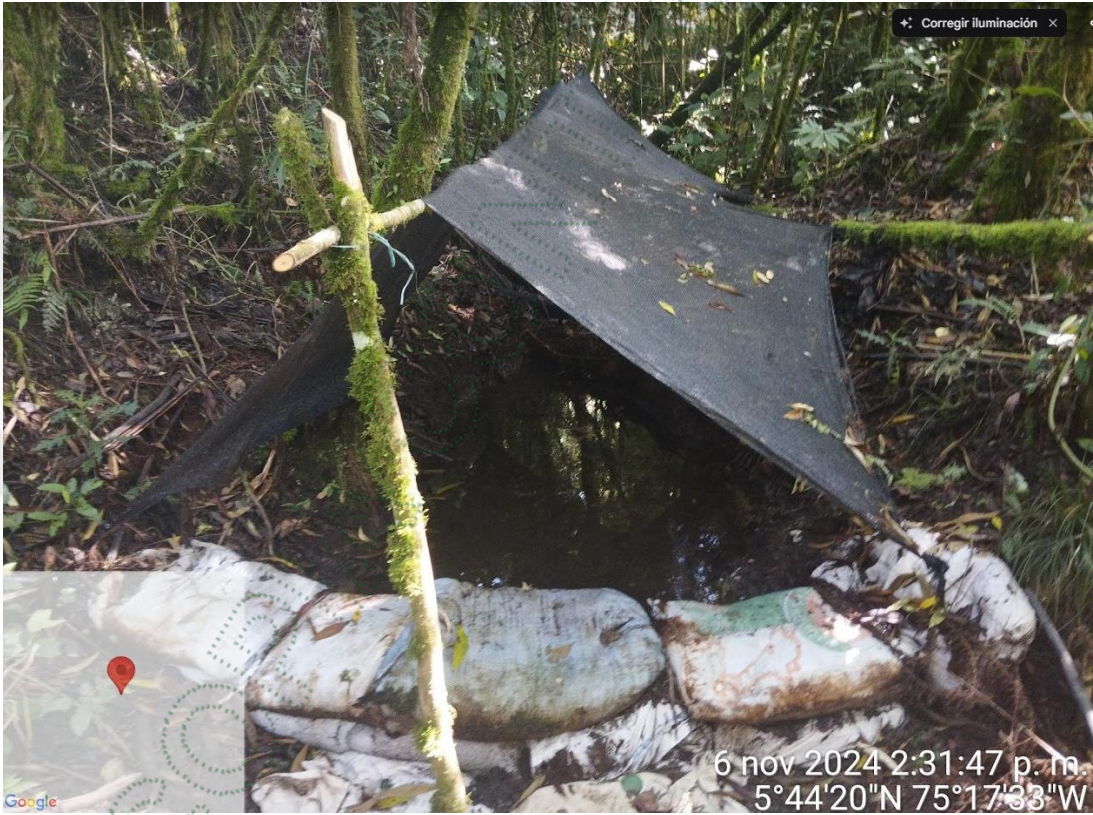
Cámara de toma directa artesanal a desarenador
