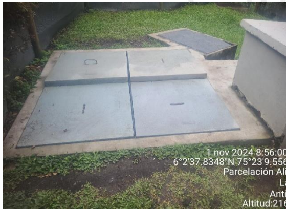
Fotografía 1. MH ubicado en el Lote 24.
