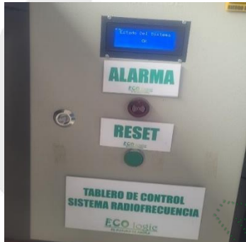
Fotografía 3. Tablero de control, sistema de radiofrecuencia del MH C25, lote 24
