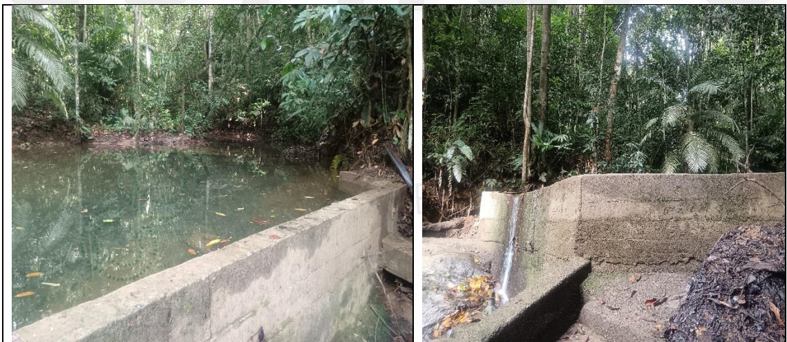
Sitio de captación de la fuente hídrica Dos Quebradas
