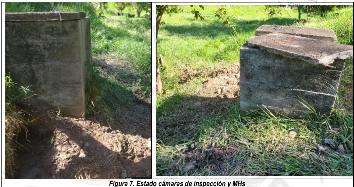
Figura 7. Estado cámaras de inspección y MHs
