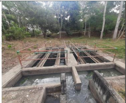
Figura 3. Unidades primarias (Sedimentadores) - Planta de tratamiento de aguas residuales del Corregimiento de Puerto Perales
