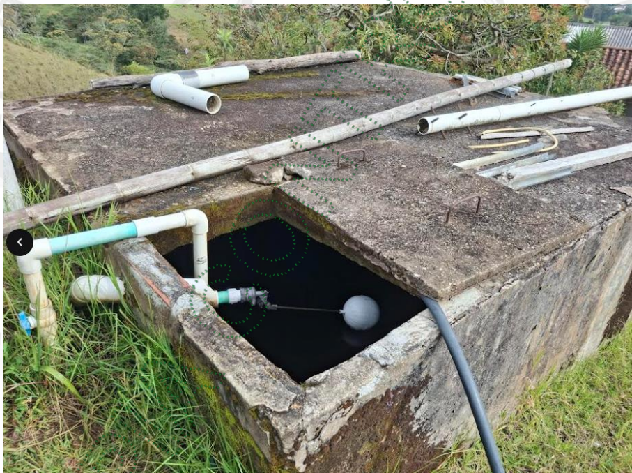
Imagen 4. Tanque de almacenamiento con dispositivo de control de flujo.
