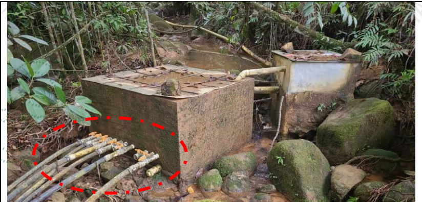
Figura 4. Punto de captación y tanque de almacenamiento, aprovechamiento de agua para USO RECREATIVO, que beneficia a 10 propietarios del Sector La Sirena
