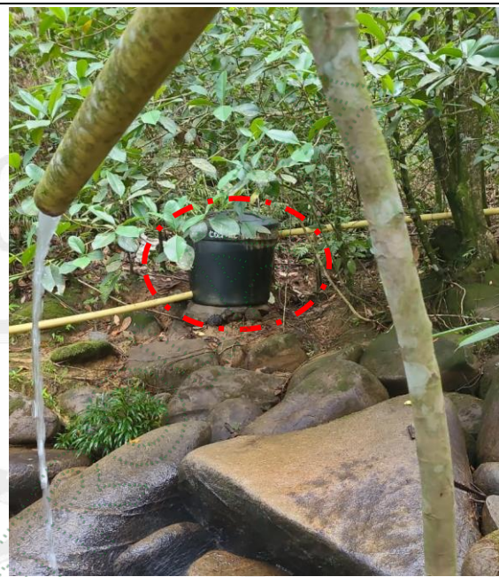
Figura 6. Tanque de almacenamiento, aprovechamiento de agua para USO DOMESTICO Y RECREATIVO, que beneficia al establecimiento de comercio “El Morro Buenavista”
