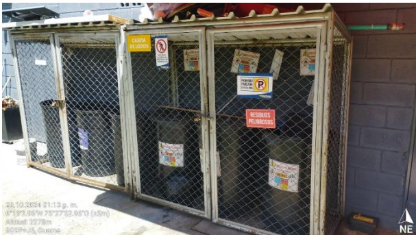
Imágenes relacionadas con la trampa de grasas del Sistema de Tratamiento de Aguas Residuales Domésticas STARD.
