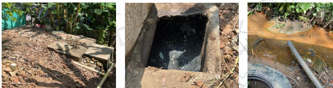
Figura 4. Pozo séptico 2 y punto de descarga. Vereda La Florida, municipio de Puerto Triunfo. Fuente: Cornare 2024.
