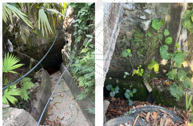
Figura 2. Sitio de descarga del vertimiento proveniente del pozo séptico 1. Fuente: Cornare 2024
