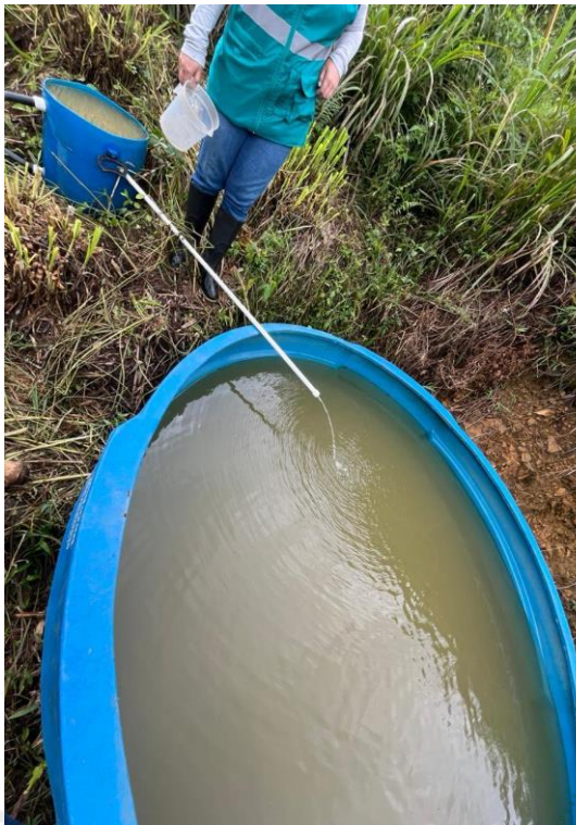
Imagen 3. Obra de captación Fuente La Cabaña
