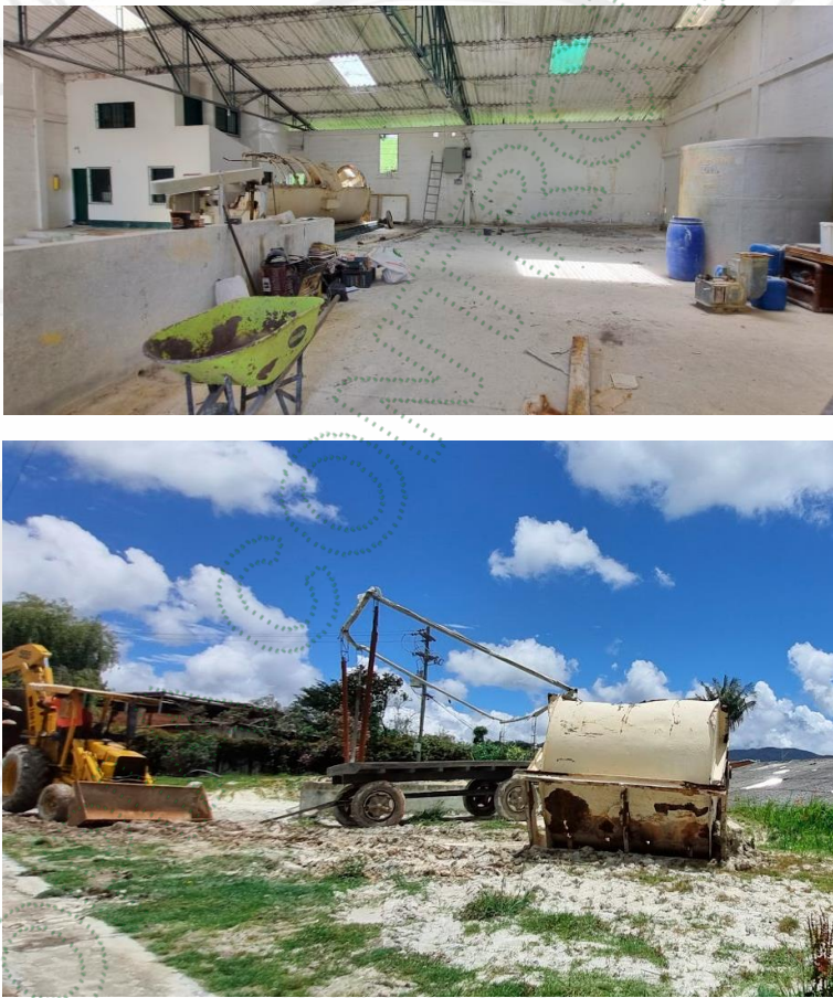
Imagen 1. Estado actual planta de beneficio de caolín.
