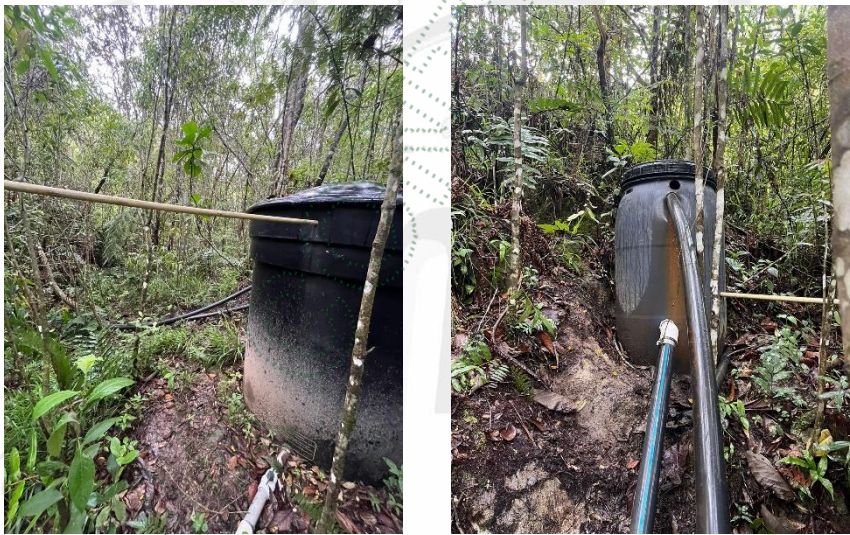
Imagen 1. Obra de captación Fuente Las Acacias
