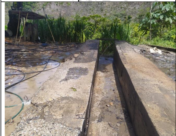
Figura 7. Guaje de lavado de vehículos en el predio 2.
