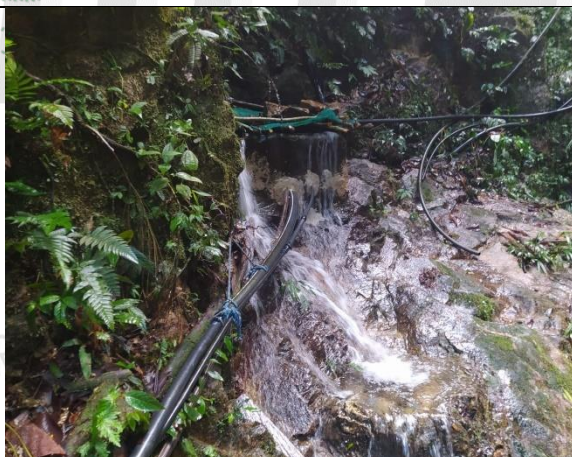
Figura 2. Cámara de derivación de agua para el predio 1 .
