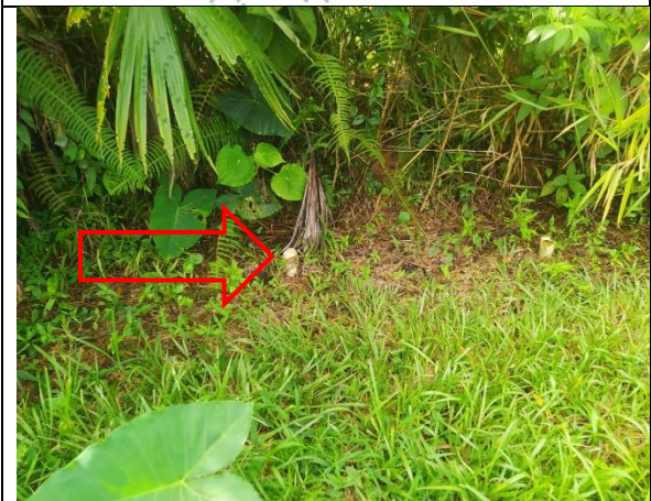
Figura 3. Tanque en mampostería donde llegan las ARD del predio 1 .
