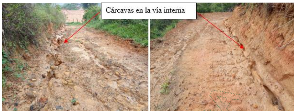
Figura 9. Cárcavas en la vía
