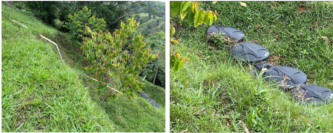
Foto 4 y 5. Tubería de conexión al tanque séptico, instalado para el proyecto “Glamping El Sueño” Fuente: Cornare 2024
