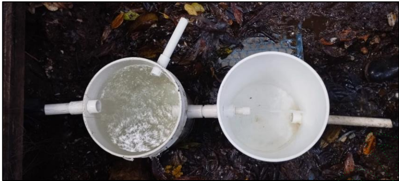
Figura 1. Obra de control de caudal implementada en la fuente Olivares
