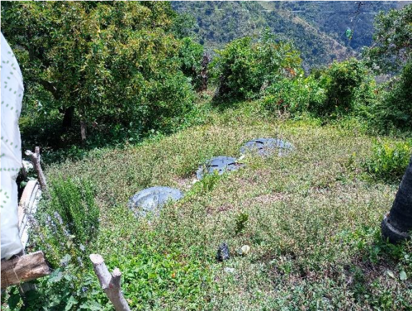
Sistema de tratamiento
