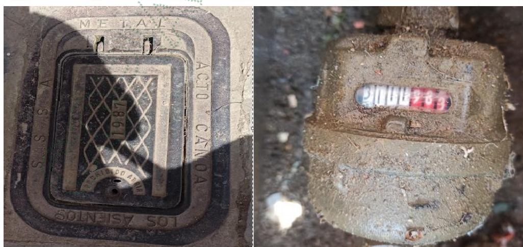
Imagen 4. Tapa del contador y micromedidor
