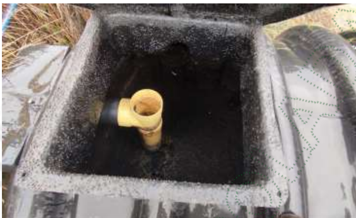
Compartimiento Pozo séptico lleno
