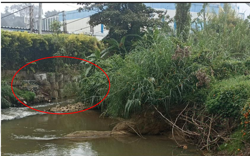
Ilustración N° 7. Muro en gaviones y Big Bags en la margen izquierda de la fuente, aguas abajo de la obra proyectada
