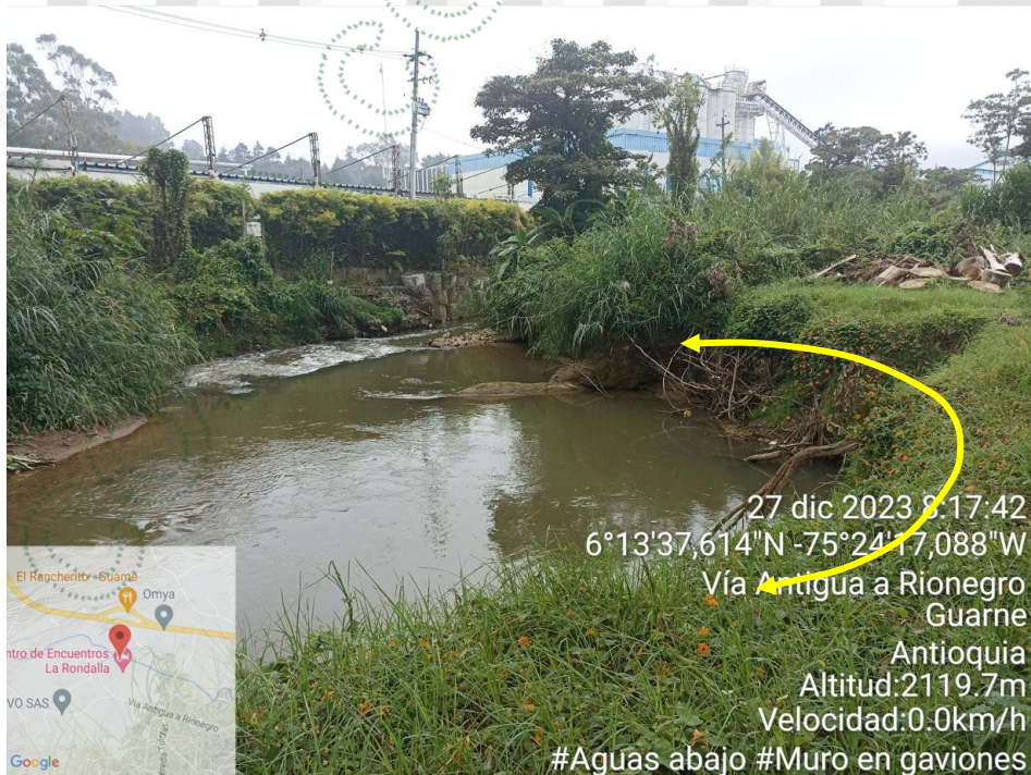
Ilustración N° 6. Proceso de deslizamiento del tipo caído por la influencia de la dinámica de la Quebrada La Mosca
