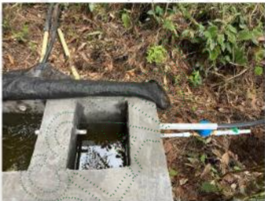
Imagen 3. Obra de captación con micromedidor de salida
