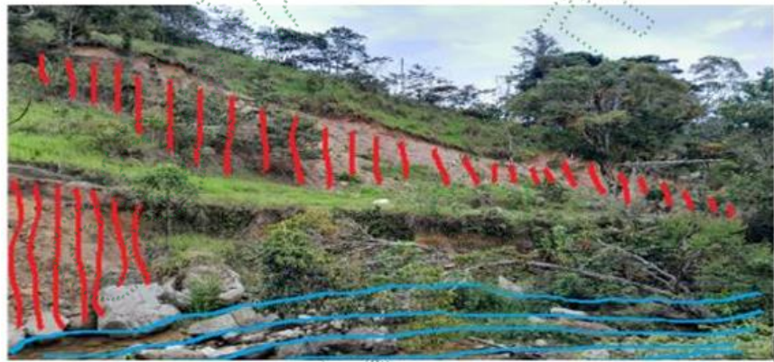
Imagen del estado actual del predio y las afectaciones provocadas sobre la ronda hídrica.
