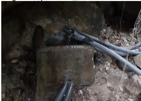
Imagen 1. Captación fuente bocatoma San Juan
