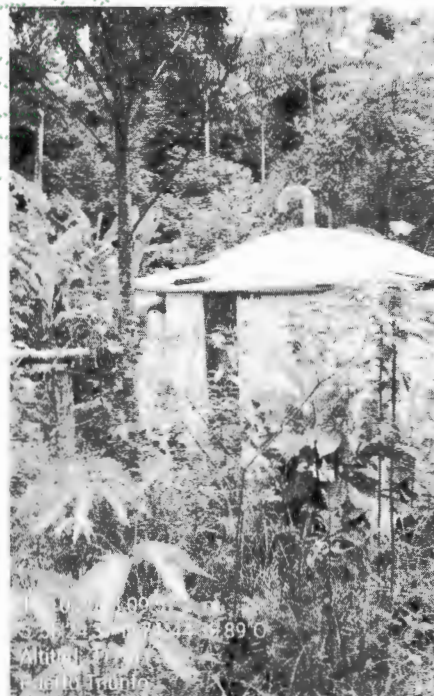
Tanque de almacenamiento de 100 m 3
