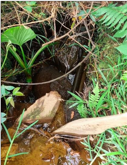
1. Captación en la fuente “Sin Nombre o Los Osorios”
