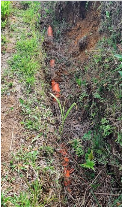
2. Conducción en tubería
