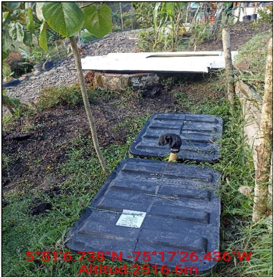
Sistema séptico instalado adecuadamente
