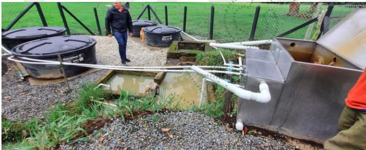
Imagen 12. Obra de reparto y sistemas de almacenamiento
