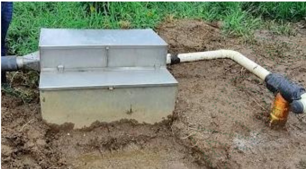
Imagen 9. Obra de control de caudal.
