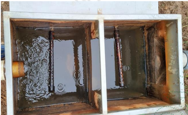
Imagen 10. Obra de control de caudal.
