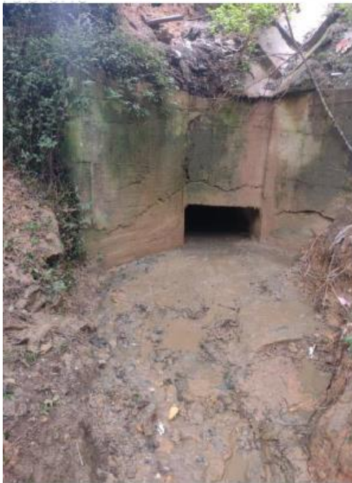
Ilustración 1 Previo a la limpieza.
