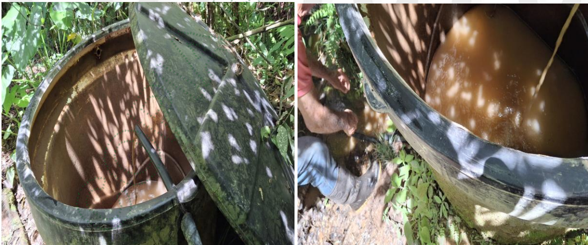
Tanque de almacenamiento
