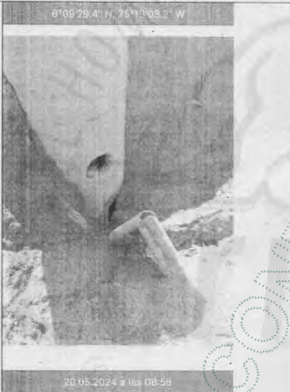
Ilustración N° 5. Entrada de Tubería de 24" a MH interrumpida
