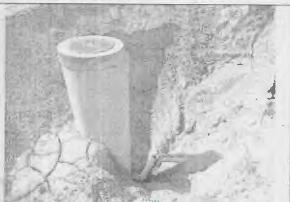
Ilustración N° 4. Tubería de 24" quebrada a la entrada de MH
