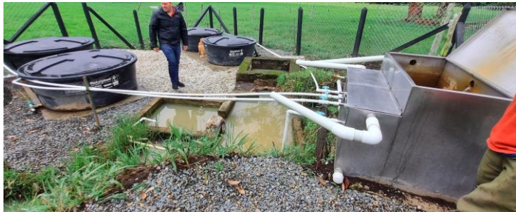
Imagen 12. Obra de reparto y sistemas de almacenamiento
