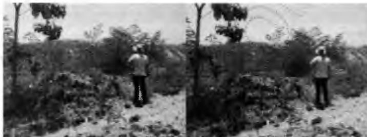
Foto 12. Desarenador implementado en la EDS Distracom y material del movimiento de tierra ocasionado por Distracom. Fuente: Comare, 2024.
