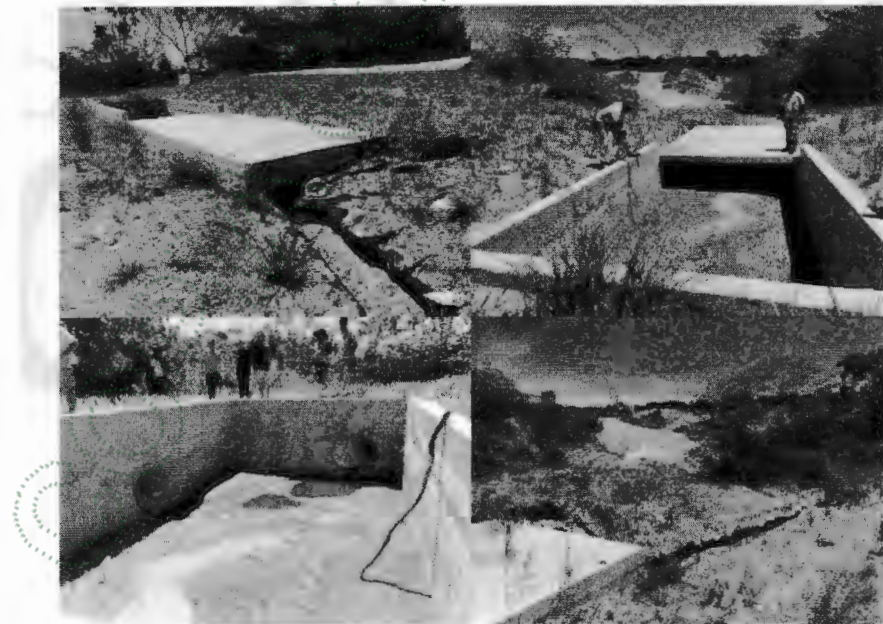
Foto 4, 5, 6 y 7. Desarenador implementado en la EDS Distracom. Fuente: Cornare, 2023.
